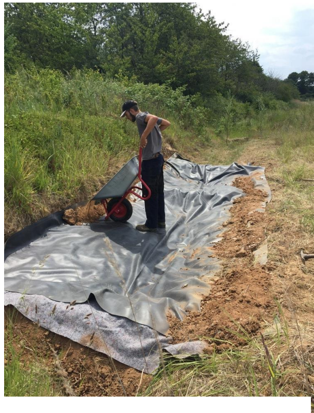
Anlage eines kleinen Foliengewässers als Notmaßnahme für das Vorkommen der Wechselkröte an der Grootestraße, Bonn-Dransdorf.
